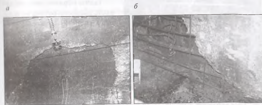
Рис. 3.3. Несквозной вывал в своде обделки (а) и сквозной в стене (б)
