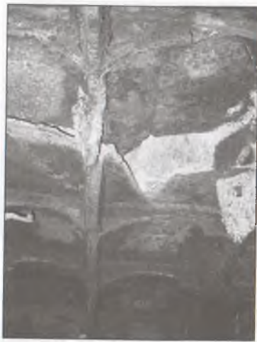
Рис. 3.6. Разрушение чугунного тубинга в обделке тоннеля в результате химической и электрохимической коррозии металла
