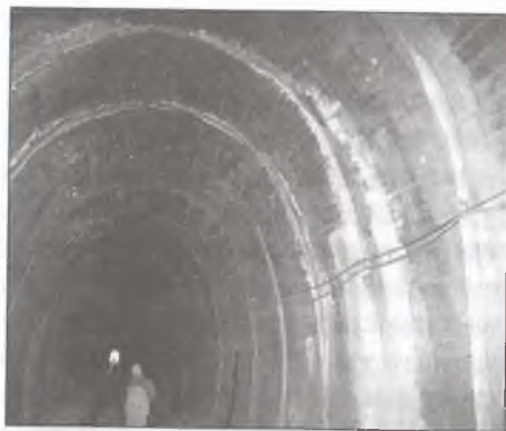
Рис. 3.1. Кольцевые трещины с высолами по холодным швам
