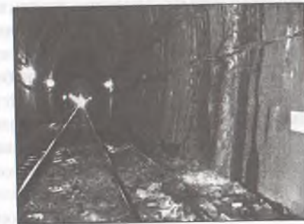
Рис. 4.12. Наледи в железнодорожном тоннеле
