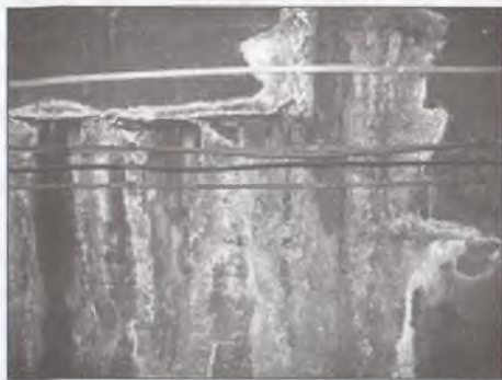
Рис. 3.4. Разрушение поверхностного слоя обделки в результате выщелачивания бетона
