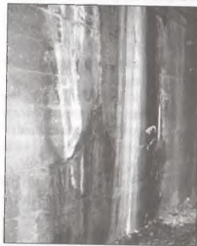
Рис. 3.7. Течь из деформационного шва и из трещины в обделке
