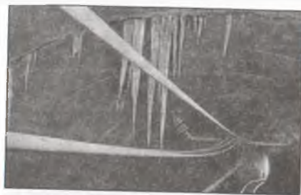
Рис. 4.13. Наледи (сосульки) в своде тоннеля
