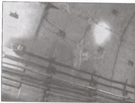
Рис. 3.5. Сколы, трещины и высолы в блоках сборной железобетонной обделки
