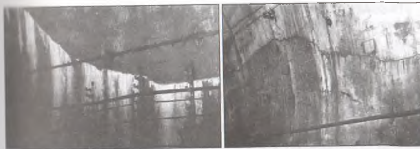
Рис. 3.2. Наклонные трещины в бетонной обделке раскрытием 5—6 мм с интенсивными высолами
